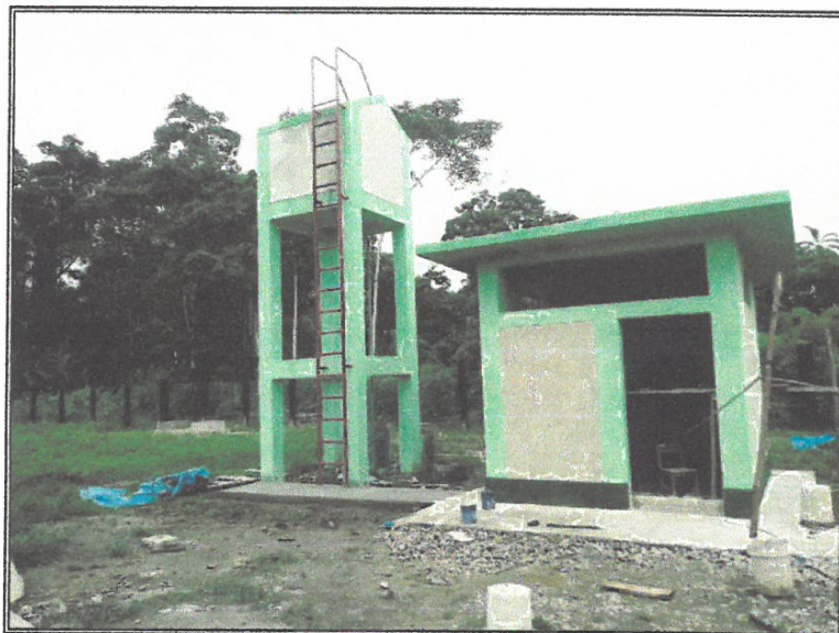
Vista N° 03: tanque elevado y caseta para pozo perforado.
